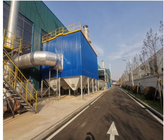
TA002 废气处理设备现场照片
