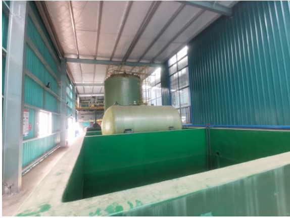
事故应急池现场照片
