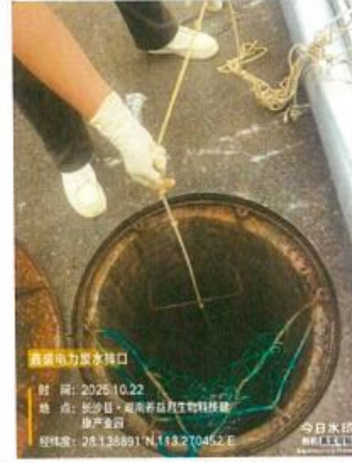
隔油池+化粪池 W2 (采样日期: 2025-10-22)
