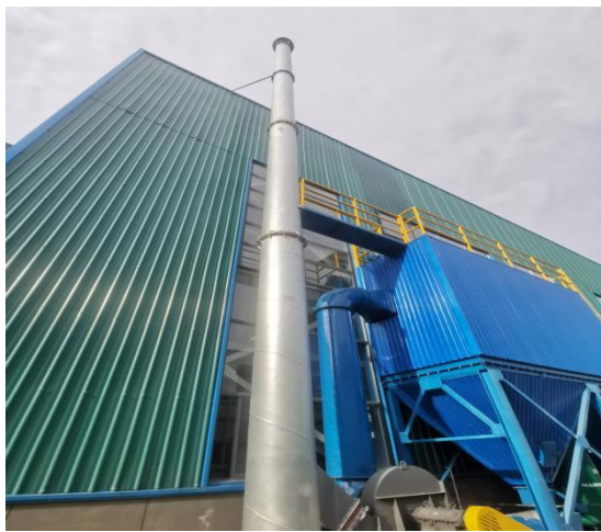
废气排放口 DA004 现场照片
