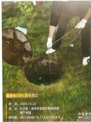
隔油池+化粪池 W1 (采样日期: 2025-10-22)
