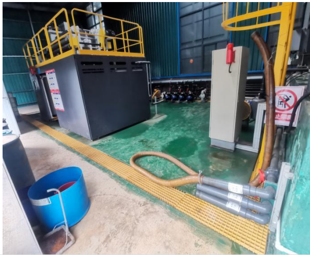
废水处理站现场照片
