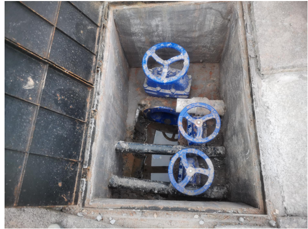
雨水排放口切换阀门
