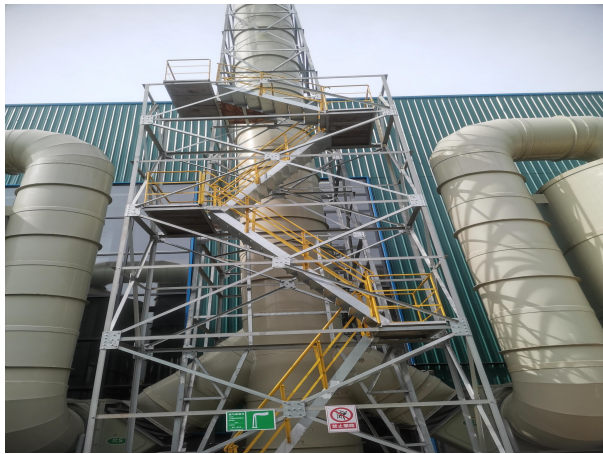
废气排放口 DA001 现场照片
