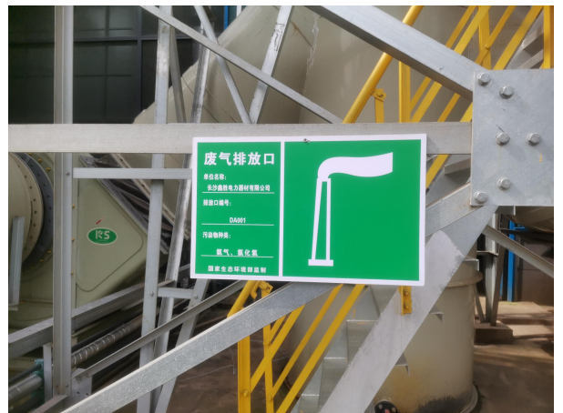
废气排放口 DA001 标识牌现场照片
