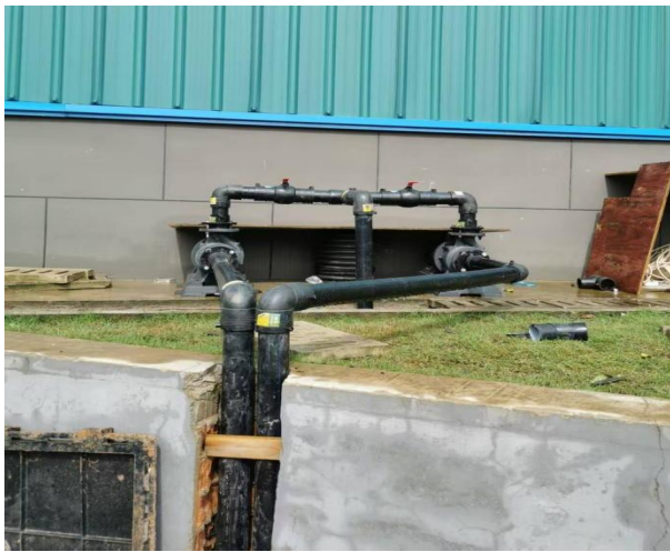
雨水收集池和应急池的应急泵现场图片
