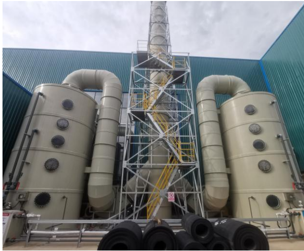
TA001 废气处理设备现场照片
