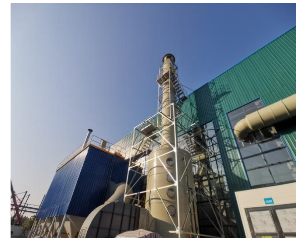
废气排放口 DA002 现场照片
