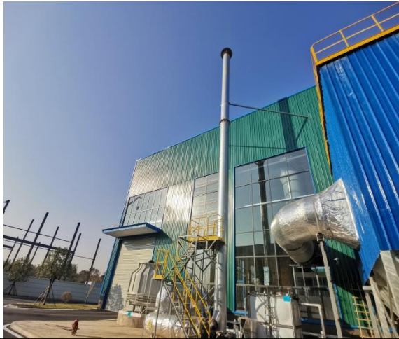
废气排放口 DA003 现场照片
