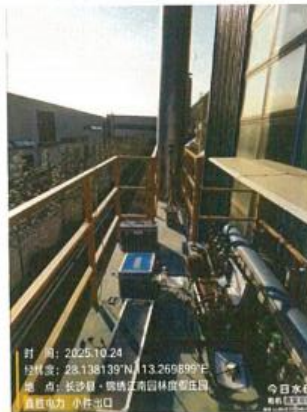
排气筒 (DA004) 出口G8 (采样日期: 2025-10-24)
